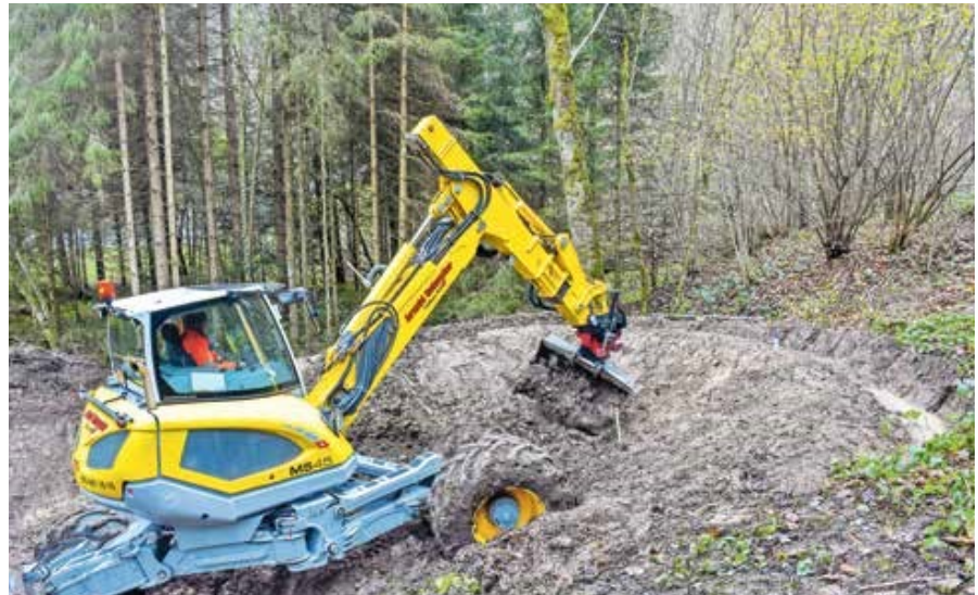
Aushubarbeiten beim oberen Teich: Dank des Schreitbaggers war das Arbeiten im steilen Gelände möglich.
