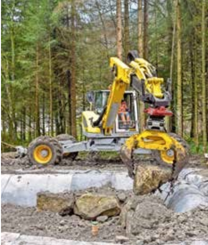
Die Nagelfluhblöcke mussten extrem sorgfältig gesetzt werden. Andernfalls drohte eine Verletzung der Teichfolie.
